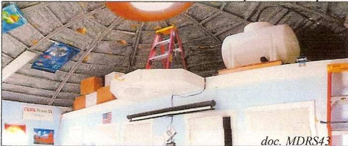
le réservoir d'eau et le système de pompage à partir de la réserve extérieure sont situés dans le loft au-dessus des chambres
